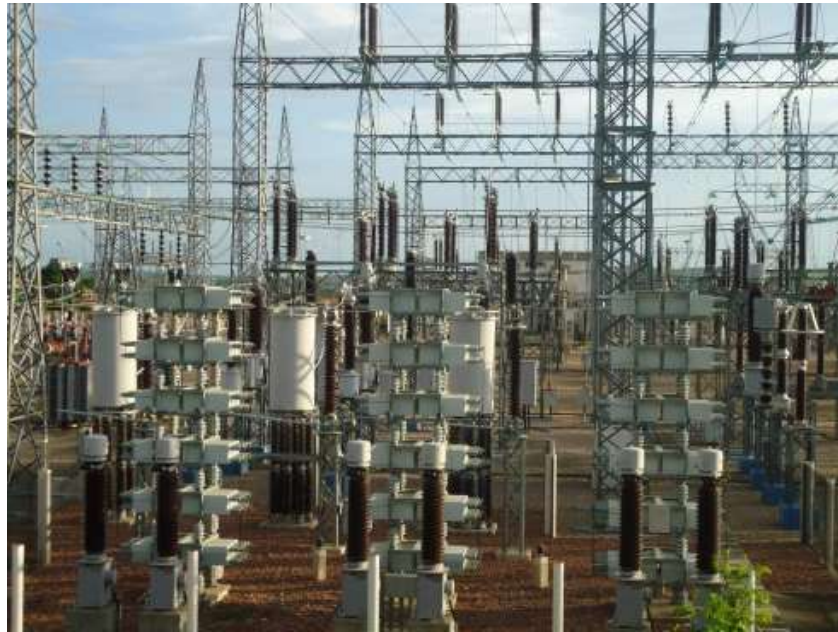
Figura 07. Banco de Capacitores 230kv
