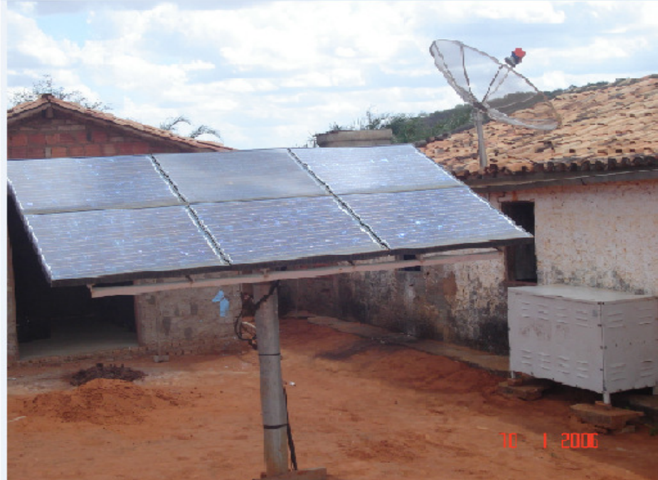
Figura 6 – Painel solar instalado na residência Fonte: COELBA
