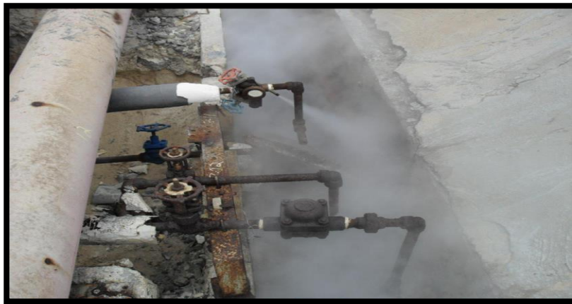
Figura 2 - Estação de vapor apresentado falha: Vazamento para Atmosfera. Fonte: Elaborado pelo autor
