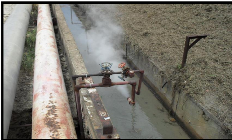
Figura 3 - Estação de vapor apresentado falha: Passagem direta. Fonte: Elaborado pelo autor.
