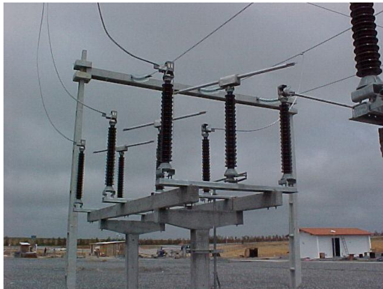
Figura 2.10 - Chave Seccionadora de Alta Tensão
