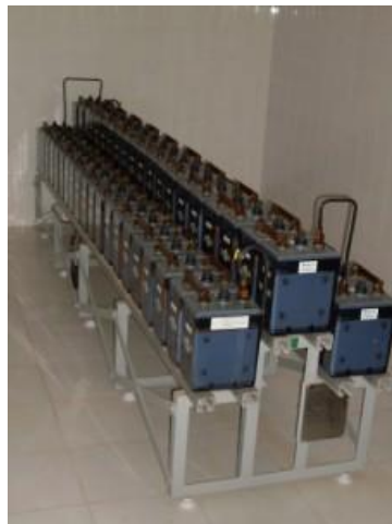
Figura 2.16 - Banco de Baterias
