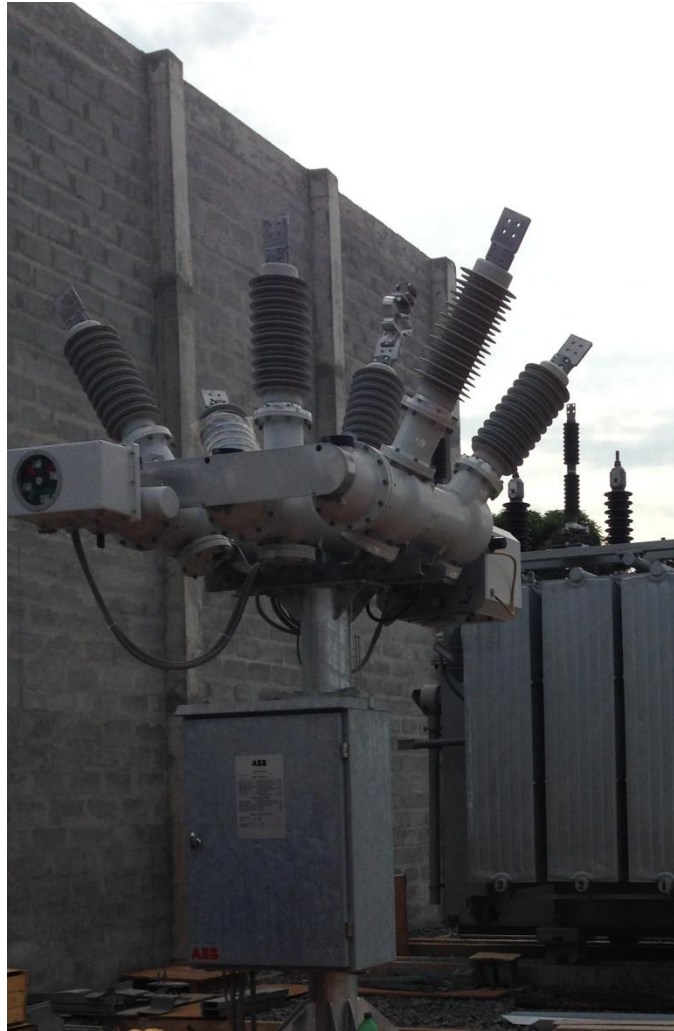
Figura 2.13 - Módulo Híbrido de Subestação
