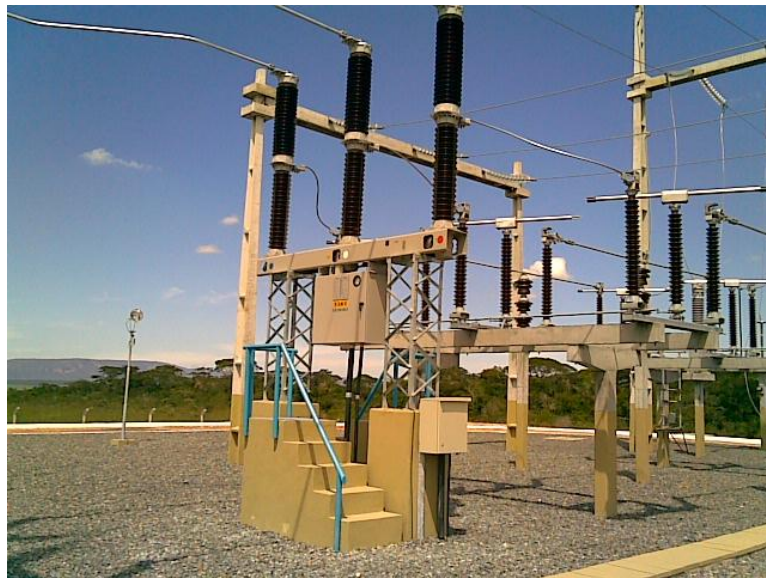
Figura 2.6 - Disjuntor de Alta Tensão
