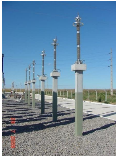
Figura 2.11 - Pára-raios de Subestação
