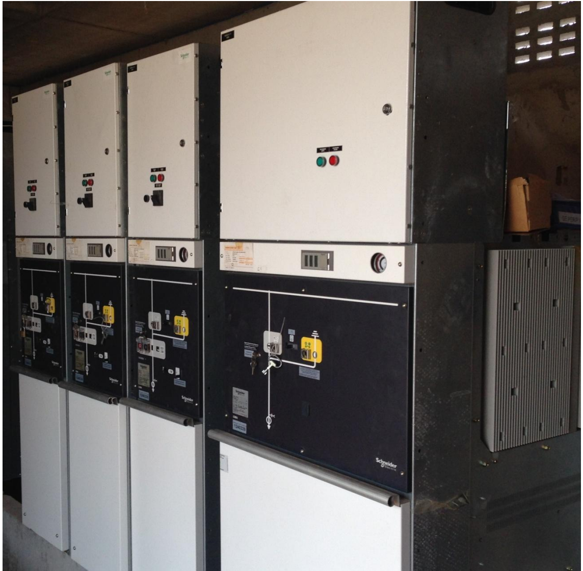
Figura 2.12 - Cubículos de Subestação
