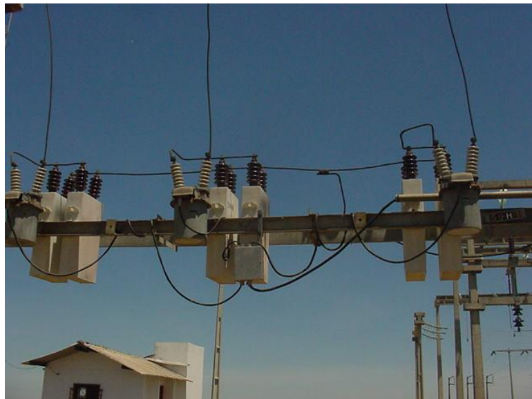
Figura 2.8 - Banco de Capacitores
