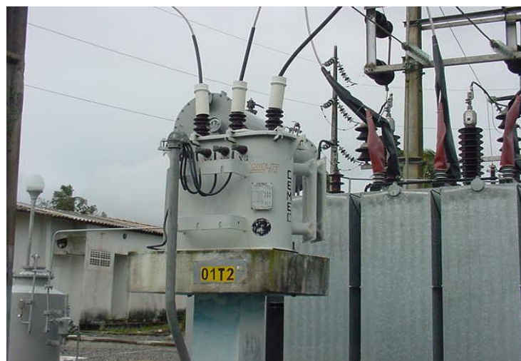
Figura 2.5 - Transformador de Serviço Auxiliar
