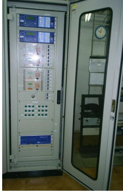
Figura 2.17 - Armário de Proteção e Controle
