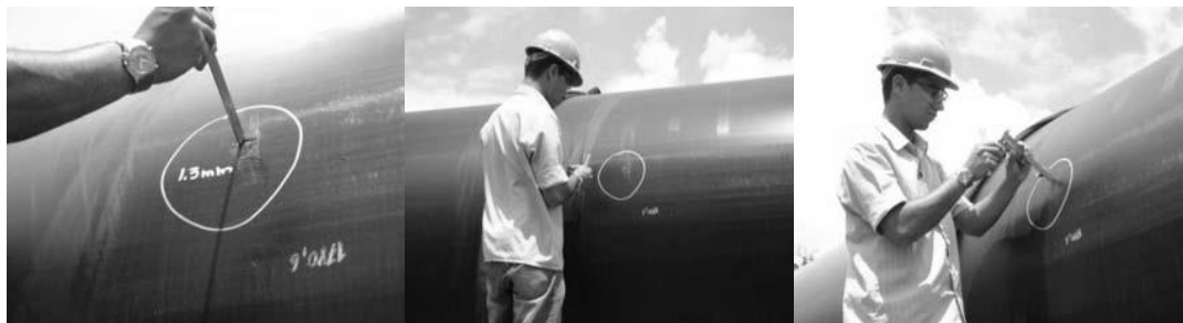
Figura 11 – Inspeção visual e dimensional nos tubos de PE antes da soldagem – tubos de PE 100 de 1735 mm, espessura de 80,1 mm.
