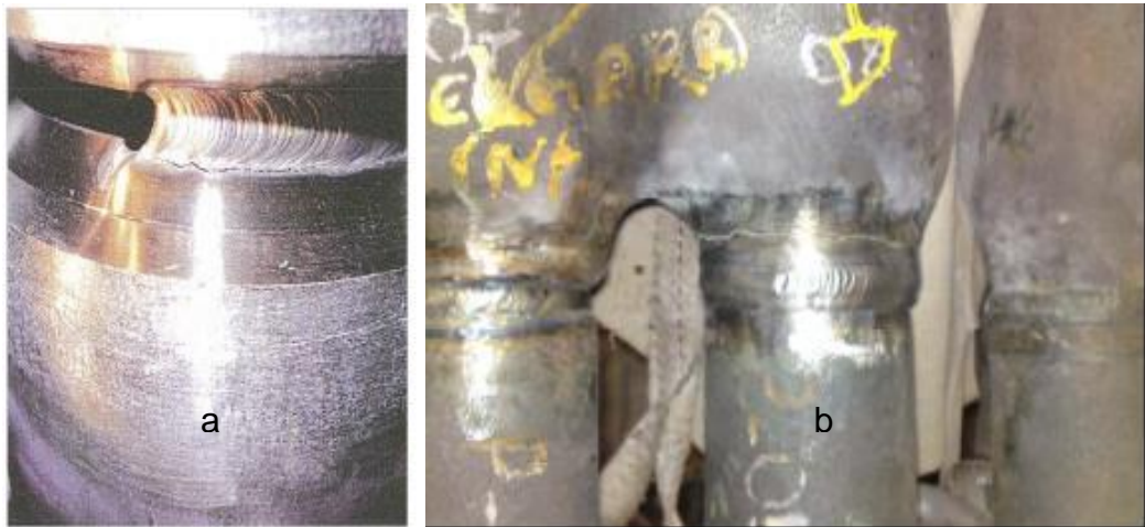
Figura 34 – a) Trincas durante execução do passe de raiz. b) Trinca na ZTA do Tetrafitting de um forno durante a soldagem de tubo novo com tubo envelhecido.
