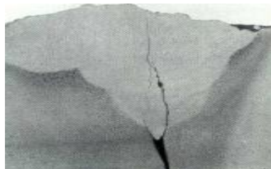
Figura 29 – Falta de penetração na raiz de uma solda de topo em uma linha de alimentação de água de caldeira.
