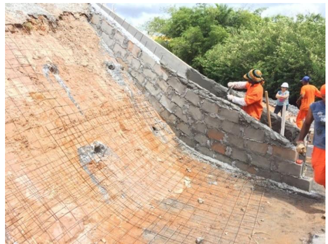
Figura 71 – Execução de outra escada drenante – Escada chumbada no talude para escoamento de água pluvial do galpão.
