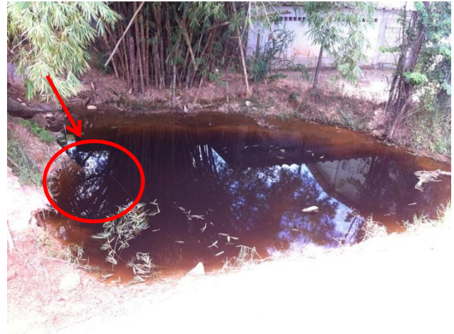
Figura 26 – Início do rio dentro do terreno. Tubo Ribloc submerso que atravessa a rodovia.
