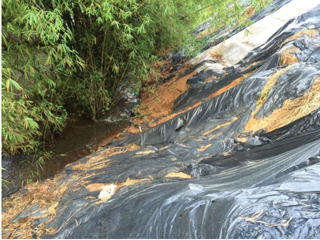
Figura 54 – Talude instável apresentando escorregamentos.
