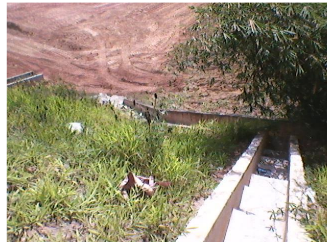
Figura 28 – Escadas de drenagem pluvial da BA-526 em direção ao terreno da obra.
