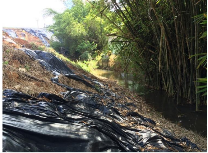
Figura 55 – Talude instável apresentando mais movimentação de terra.
