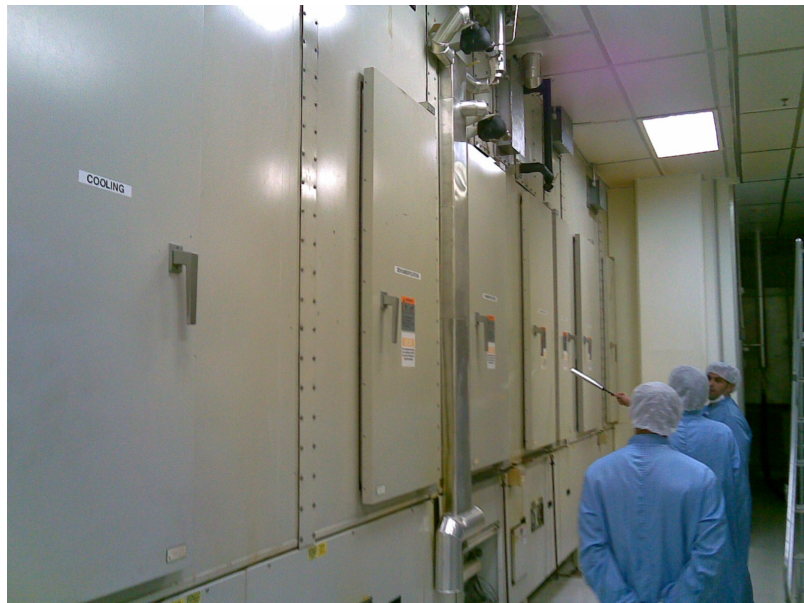
Figura 6. Parte do equipamento principal da Seção B
