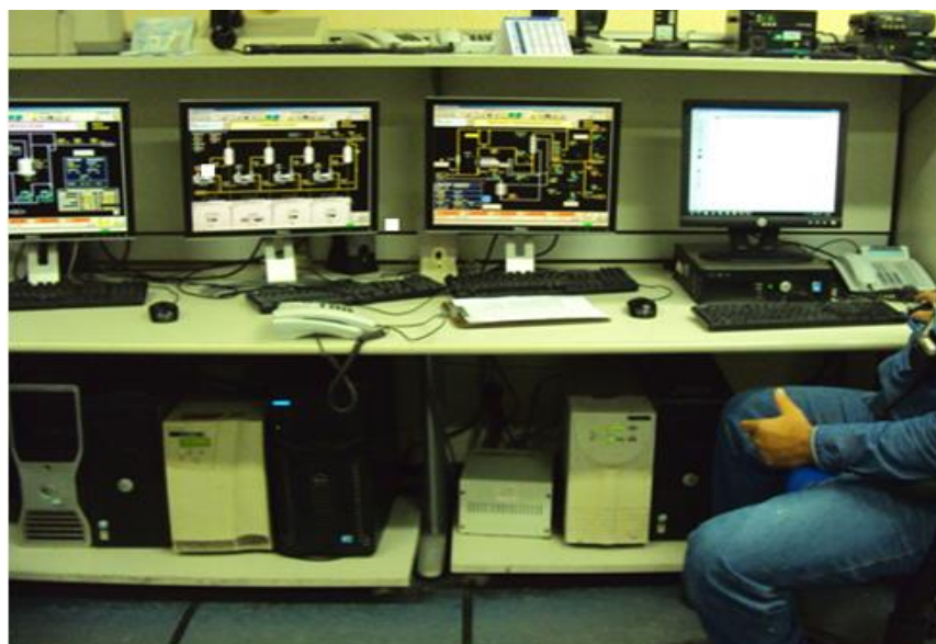
Figura 2 – Arquitetura do SDCD em sala de controle
