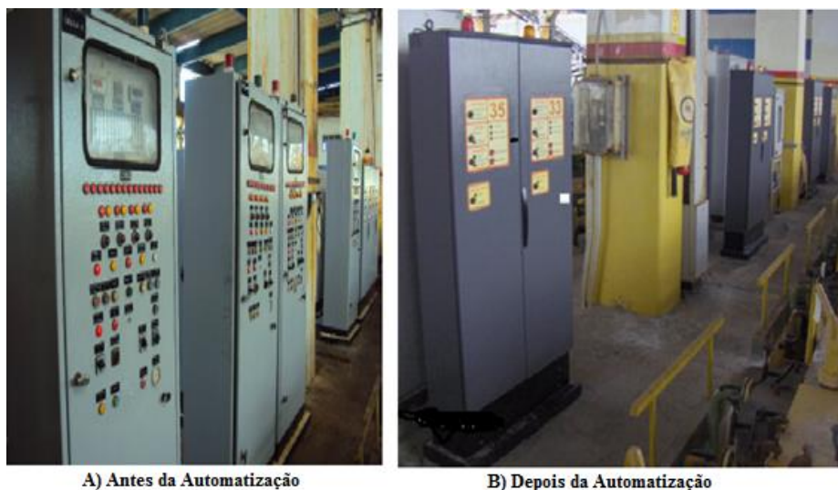
Figura 6 – Painéis de relés e automatizados
