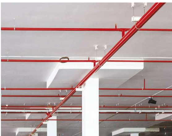
Figura 14: Tubulações aparentes para sprinklers
