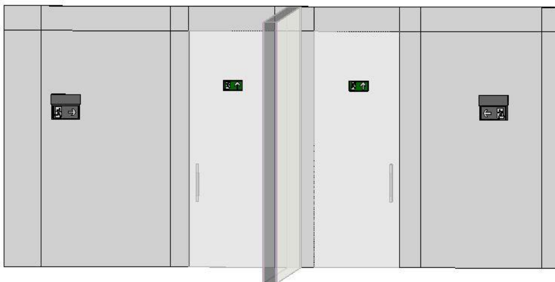
Figura 24 - Placas de sinalização
