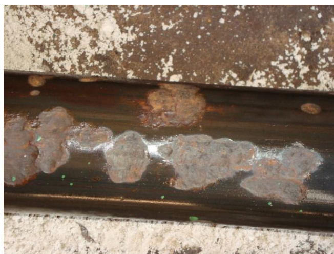
Figura 6: Corrosão na camisa do motor ou bomba BCS devido ao fluido corrosivo.
