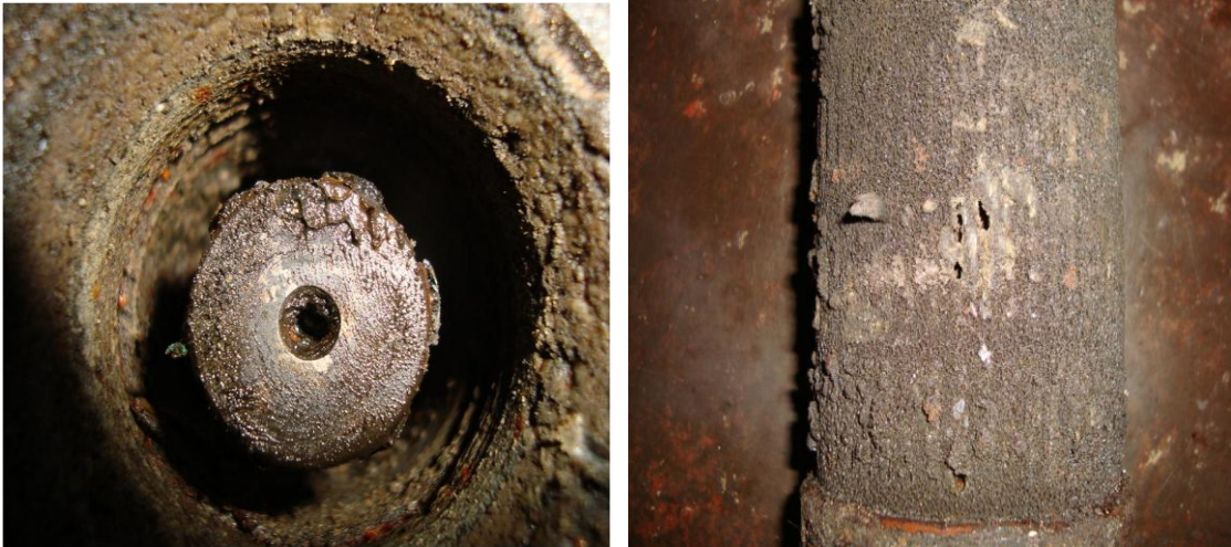
Figura 7 A e B: Incrustação no eixo e na admissão da bomba BCS
