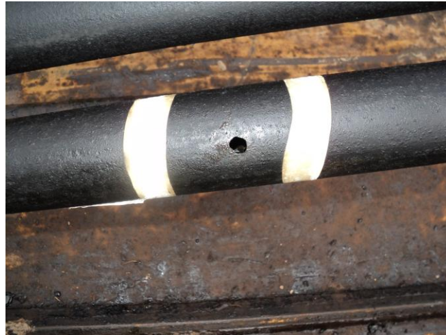
Figura 5: Corrosão e furo na tubulação devido ao fluido corrosivo produzido pelo poço.
