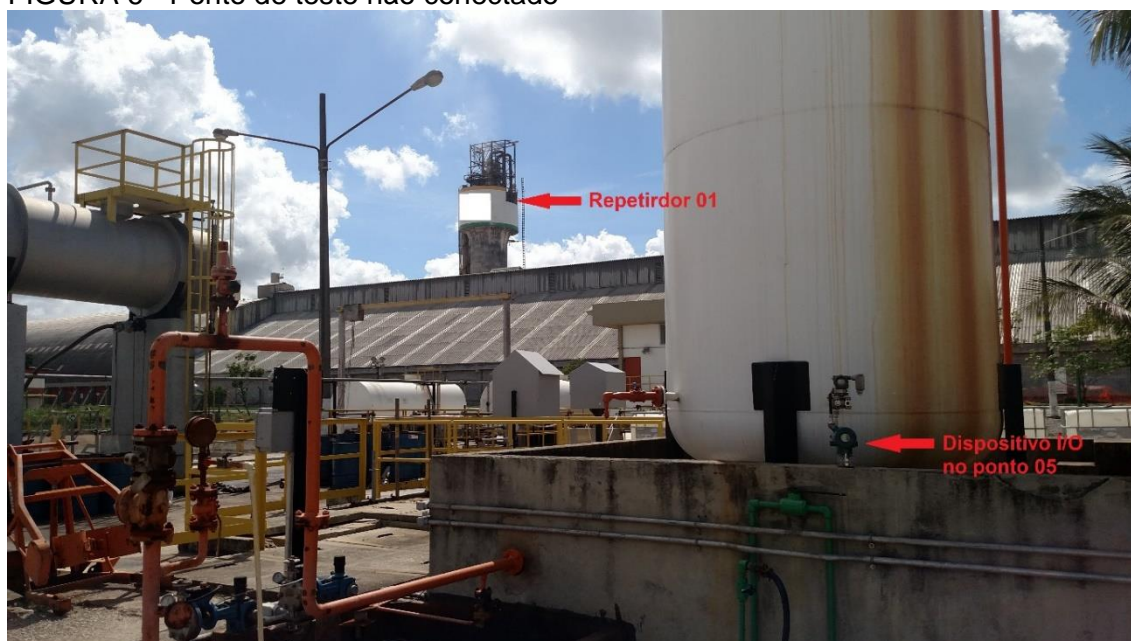
FIGURA 6 - Ponto de teste não conectado
