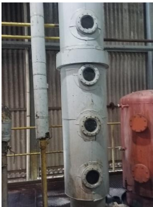
Figura 4 - Torre de contato utilizada na neutralização do óleo
