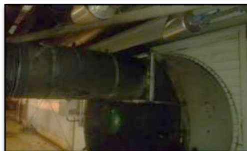
Figura 09-Ventilador axial e montante do duto flexível.
