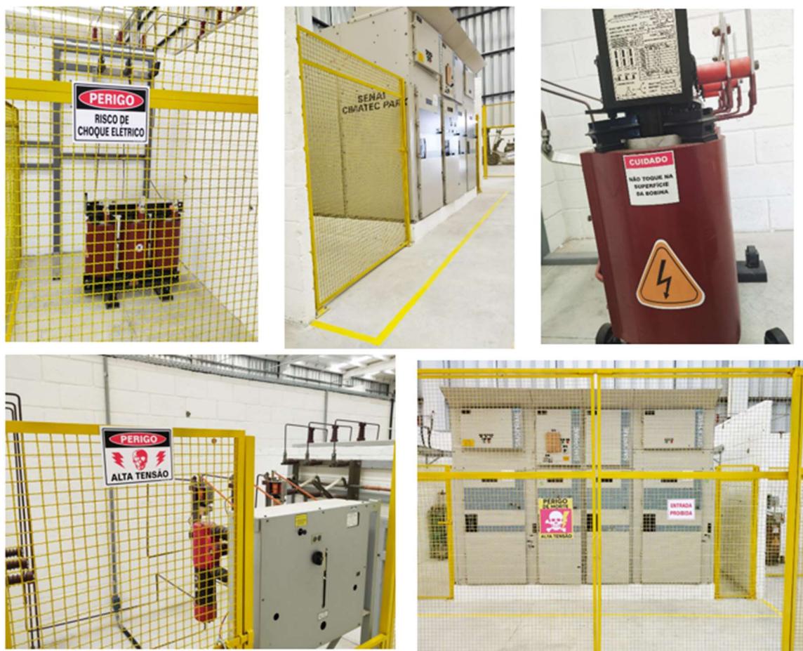
Figura 21 – Sinalização vertical e horizontal de equipamentos e controle de acesso
