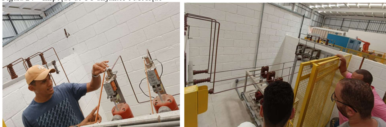
Figura 24 – Inspeção de TC disjuntor e Medição
