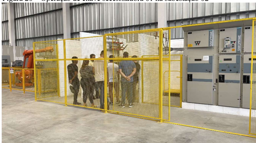
Figura 20 – Operação de chave seccionadora 01 na subestação 02
