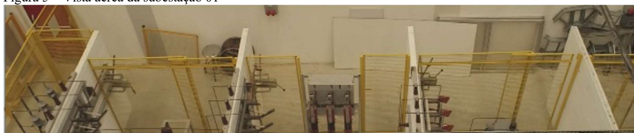
Figura 5 – Vista aérea da subestação 01
