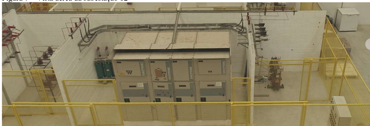
Figura 7 – Vista aérea da subestação 02
