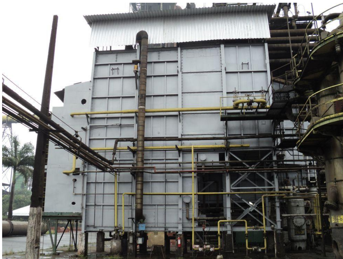
Figura 22– Foto da área externa da caldeira.
