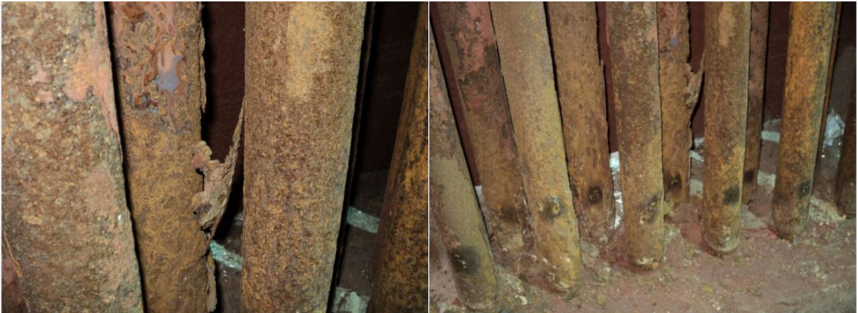
Figuras 32: Fotografia das paredes externas da tubulação no interior da caldeira, mostrando o desprendimento de produto de corrosão após o abaixamento e controle da umidade por aquecimento.
