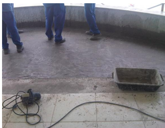
Foto 5.1 – Laje de varanda com rebaixo insuficiente
