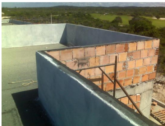
Foto 5.14 – Impermeabilização em laje de cobertura com a platibanda sem revestimento externo
