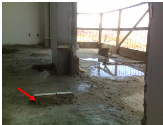
Foto 5.2 – Espessura de revestimento de piso interno para compensar falta de rebaixo na varanda
