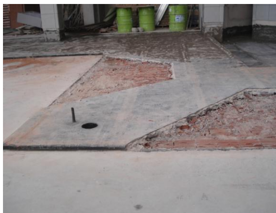
Foto 5.12 – Quebra de revestimento com dano na impermeabilização instalada
