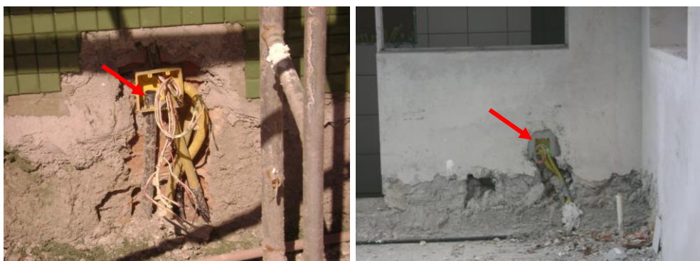
Foto 5.10 – Entrada dos conduítes na caixa de elétrica
