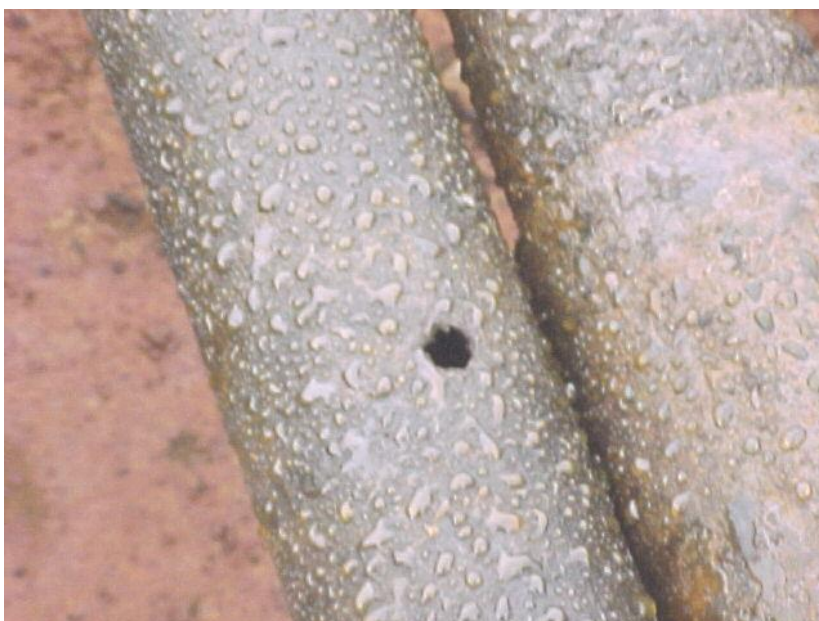
Figura 10. Tubulação com danos causado por corrosão
